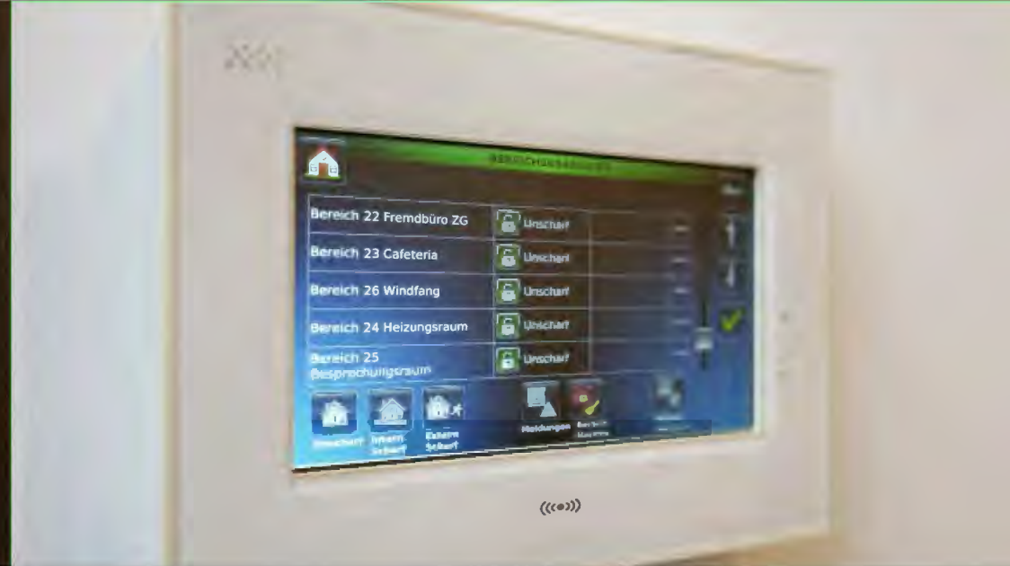
Elektronische Zugangskontrolle und Alarmanlage
