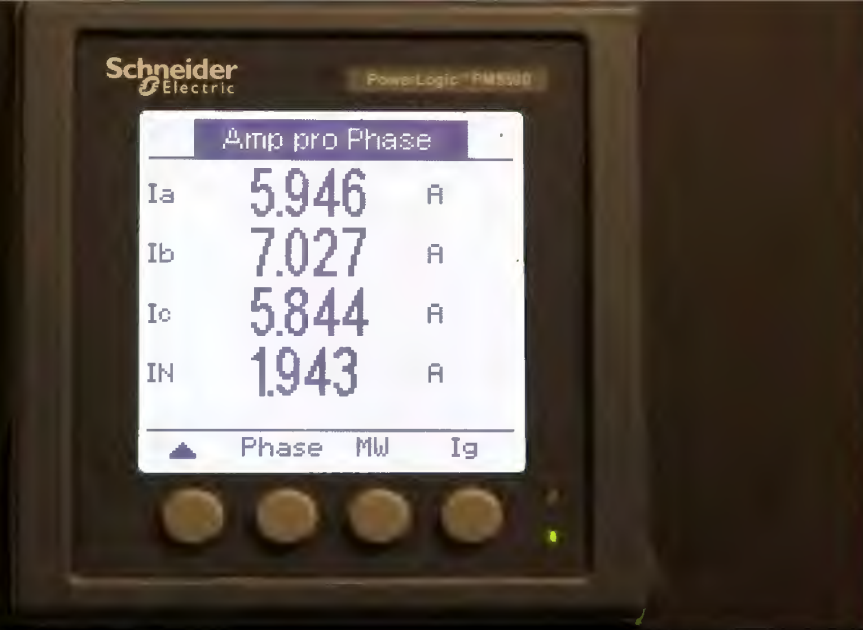
Stromverbrauch online abrufbar
